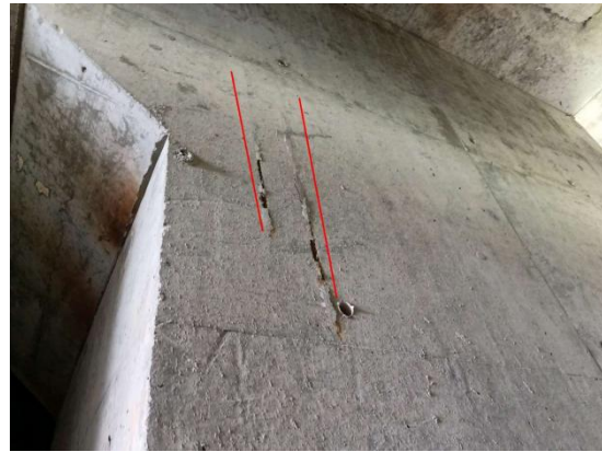
图 3-7: 桐山溪特大桥(下行) L-4-BZX 箱梁: 距 3 号墩 0m 处, 距右侧 2.5m 处钢筋锈蚀; 数量: 2 处, 宽度: 0m, 长度: 0.6m。
