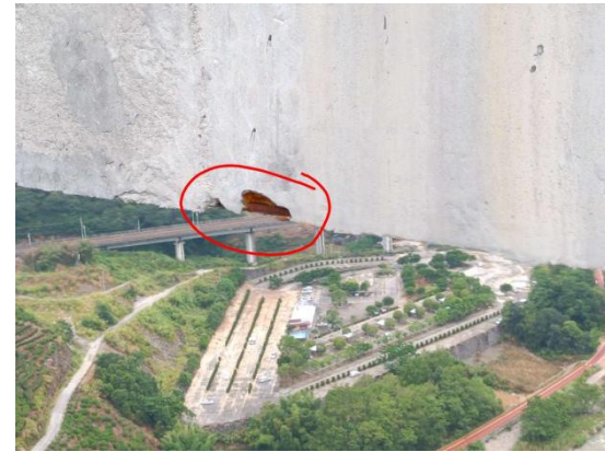
图 3-8: 桐山溪特大桥(下行) L-5-4-19 箱梁: 距 4 号墩 70m 处, 左腹板破损露筋; 宽度: 0.05m, 长度: 0.2m, 数量: 1 处。
