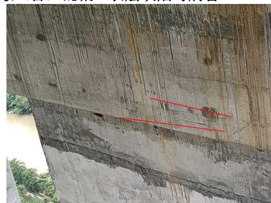
图 3-10: 桐山溪特大桥(上行) GL-R-3D 盖梁: 距右侧 2m 处, 小桩号面钢筋锈蚀; 数量: 3 处, 长度: 0.6m。
