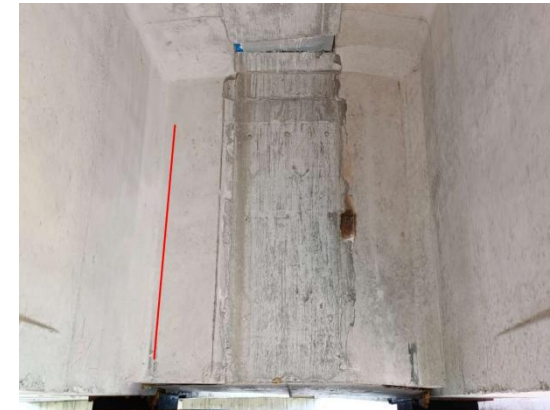
图 3-3: 桐山溪特大桥(上行) R-1-5-1H 上部一般构件: 小桩号面竖向裂缝; 数量: 1 条, 长度: 1.2m, 宽度: 0.14mm。
