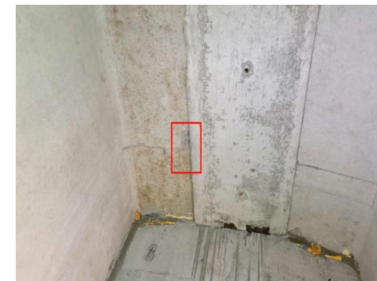
图 3-5: 桐山溪特大桥(上行) R-2-3T 梁: 距 2 号墩 1m 处, 右翼缘板掉角; 数量: 1 处, 长度: 0.1m, 宽度: 0.1m。
