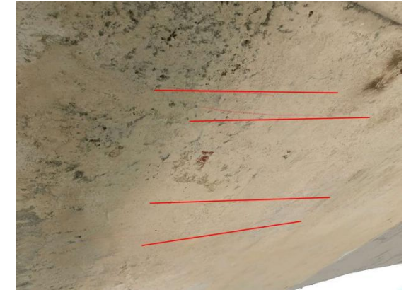
图 3-2: 桐山溪特大桥(上行) R-5-5-23 箱梁: 距 4 号墩 115m 处, 距右侧 3m 处, 梁底纵向裂缝; 长度: 1.8m, 宽度: 0.12mm, 数量: 13 条。
