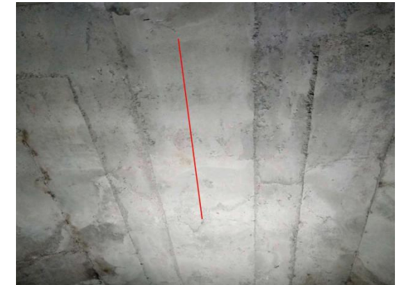
图 3-4: 桐山溪特大桥(下行) L-4-4-26 箱梁: 距 3 号墩 5m 处, 距右侧 3.5m 处, 梁顶纵向裂缝; 数量: 1 条, 长度: 2.3m, 宽度: 0.16mm。
