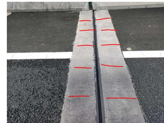
图 3-12: 桐山溪特大桥(上行) R-1f 伸缩缝: 距右侧 1m 起, 锚固区开裂; 数量: 28 处, 长度: 0.4m, 宽度: 0.20cm。
