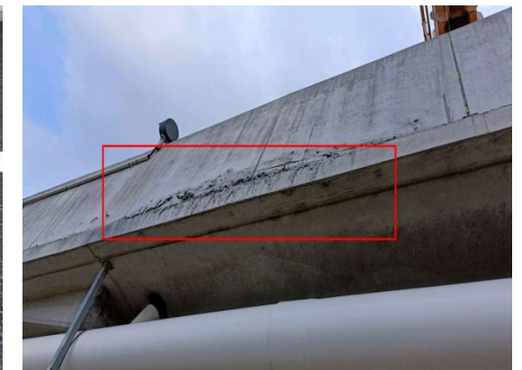
图 3-13: 桐山溪特大桥(上行) R-HL-R-1 栏杆、护栏: 距 9 号墩顶 10m 处, 右侧, 护栏剥落; 数量: 1 处, 长度: 3m, 宽度: 0.3m。
