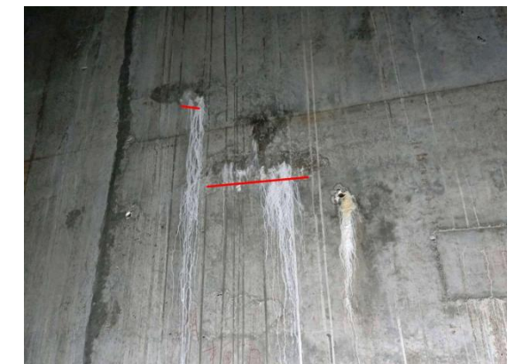
图 3-6: 桐山溪特大桥(上行) R-4-0 箱梁: 距 4 号墩 6m 处, 右腹板渗水泛碱; 长度: 1.3m, 数量: 1 条, 宽度: 0m。
